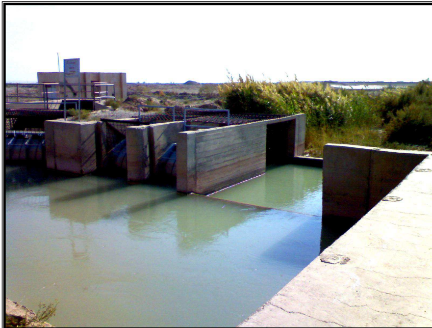
شکل (۳): حوضچه آرامش و دریچه های تنظیم و تقسیم جریان ورودی در شبکه آبیاری و تغذیه مصنوعی
